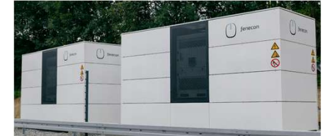
Modularer Batteriespeicher + netz. Betrieb
