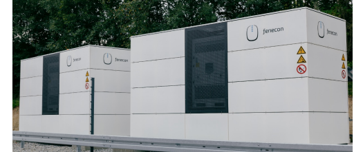
Modularer Batteriespeicher + netz. Betrieb
